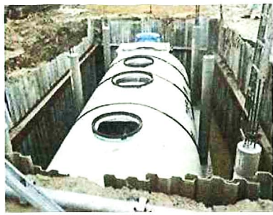
幼稚園に設置される浄化槽
